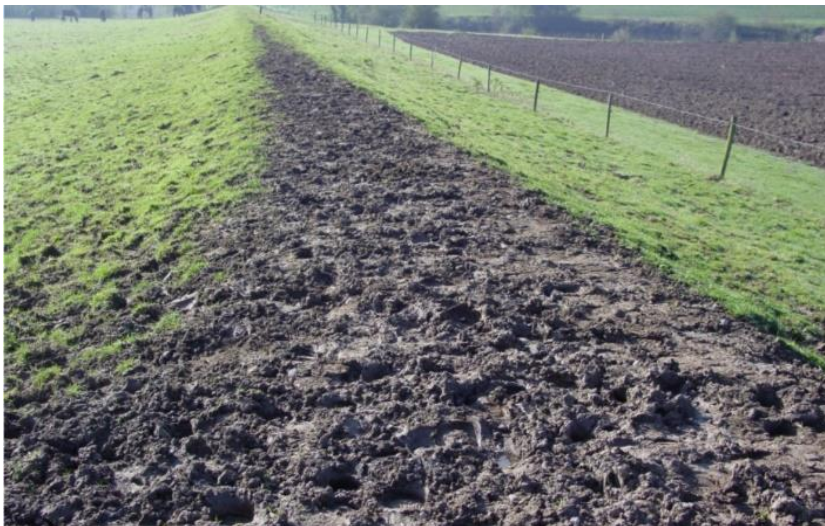
Figuur 183: Vertrappingschade door runderen (Wiki Noodmaatregelen, 2014).
